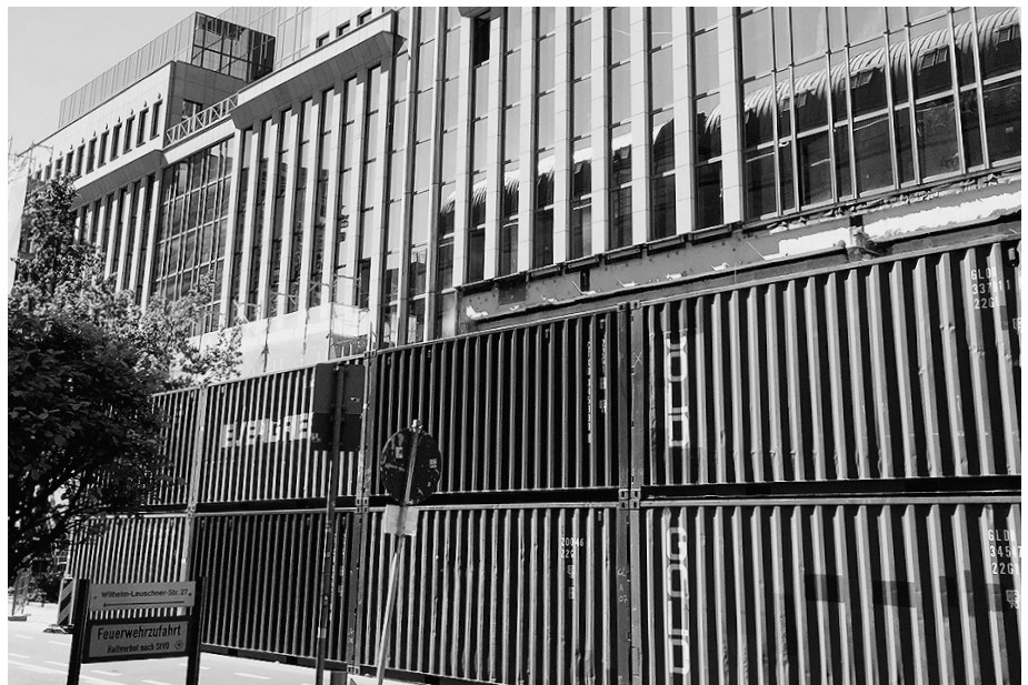
Das Hattersheimer Unternehmen Lerch bietet Container auf Baustellen u. a. als günstige Lärm- und Sichtschutzwand an. FOTO: LERCH
