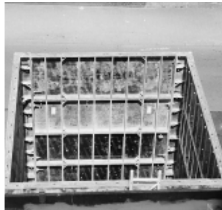
Die Konstruktion bestand aus liegend übereinander angeordneten Tafeln sowie pro Ecke zwei übereinander gesetzten Innenecken mit einer Höhe von je 2,70 m.
